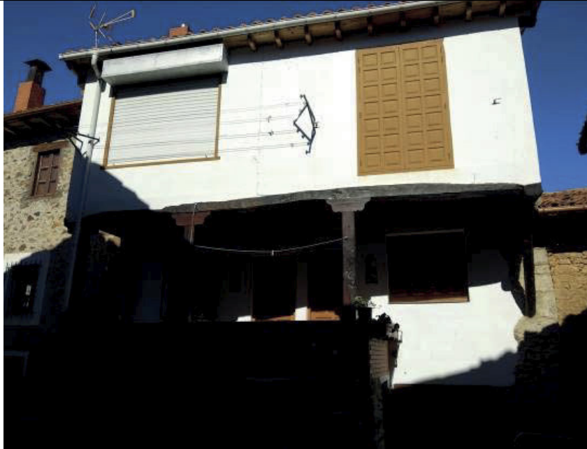
Fachada sur en plano general (edificación de la ficha 51 es la parte derecha)
